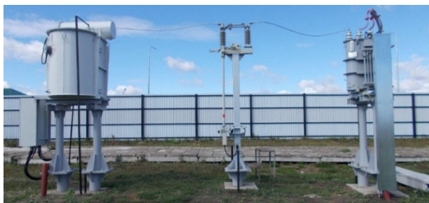
Рис. 9. Общий вид дугогасящего реактора (слева), разъединителя (середина) и фильтра нулевой последовательности (справа), размещённых на подстанции 110 кВ «Буинск»
